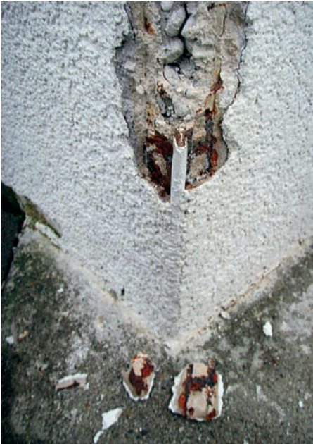
5 Auch bei dieser Sondieröffnung ist die rostfördernde Wirkung des Klebemörtels zu erkennen.
