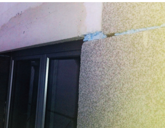
Bild 11: Nur vordergründiges Verschiessen von Fehlstellen ist nicht zielführend.
