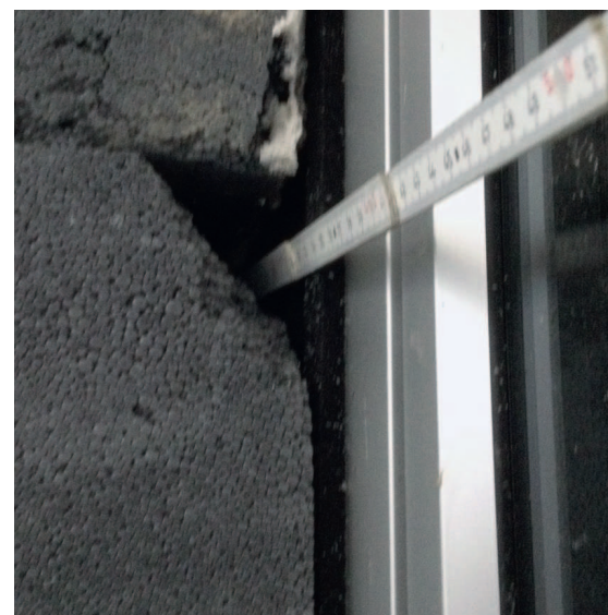
Bild 10: Fehlstellen in der Wärmedämmung.
