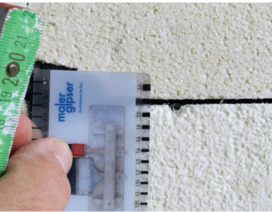
Bild 3: Offene, nicht satt gestossene Dämmplattenstösse.
