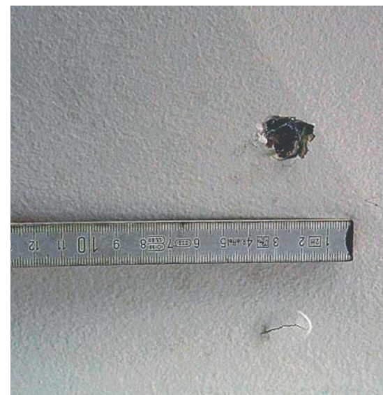
Bild 9: Wenn die Beplankung nicht mehr satt auf dem Traggrund aufliegt, sind solche Putzabplatzungen über den Befestigungsmitteln möglich.
