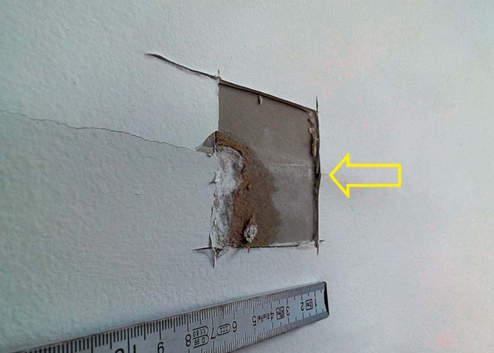
Bild 2: Die Öffnung zeigt die Quetschfalten-Bildung der Verspachtelung respektive die Hohlstelle auf der Gipsplattenoberfläche.
